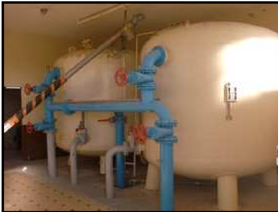
Usine du captage de la Plaine
